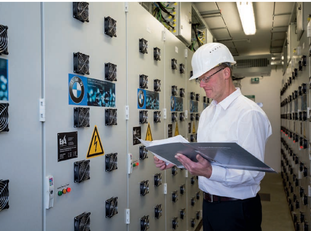
BILD 4 Second-Life-Batterieschränke der aufgebauten prototypischen Megawatt-Anlage (© BMW)
